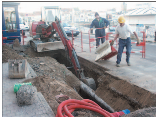
Le 1 er décembre, les ouvriers municipaux ont débuté les travaux d'eau potable
