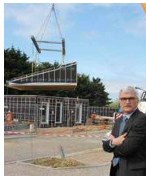
Pour terminer, la dépose du toit. Une installation spectaculaire sous les yeux du maire et de ses collègues.
